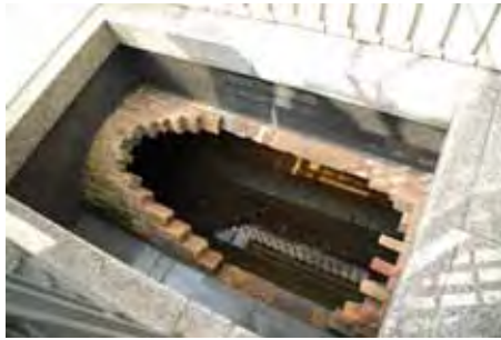
【旧居留地煉瓦下水道】 (神戸市中央区)
