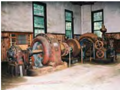
【佐渡鉱山 戸地川第二発電所(発電機)】 (新潟県佐渡市)
